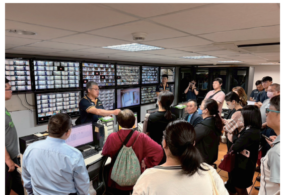
■ 圖 2、現場人員實際操作防災監控系統
