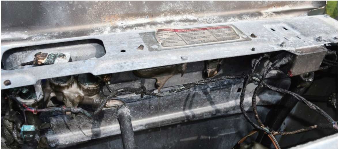
圖 8、洗衣機上方處相關電源配線，並無斷裂與嚴重受燒情況
