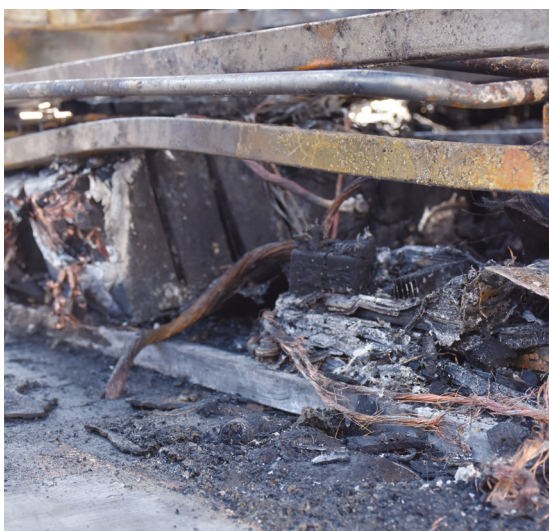
■ 圖 5、破損之鋰電池組、逆變器與零組件受燒後情況
