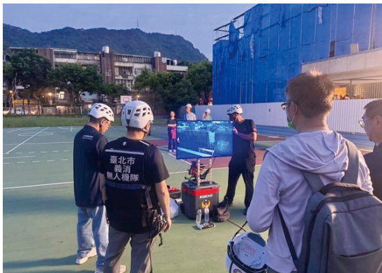
圖 7、無人機協助福德國小樓板坍塌救援 照片來源：臺北市義勇消防總隊
