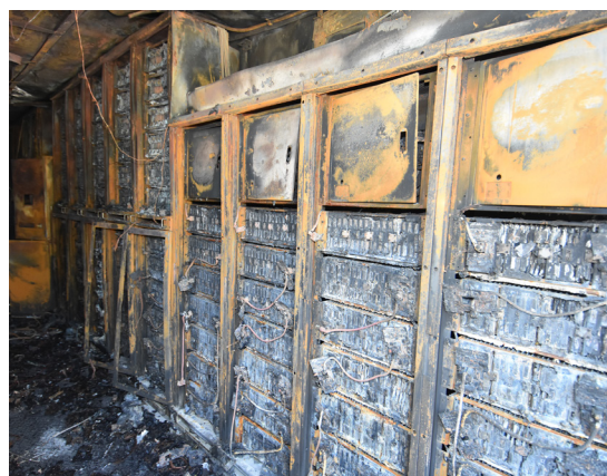
圖 19、電池櫃緩衝電池及隔離電池放置情形
