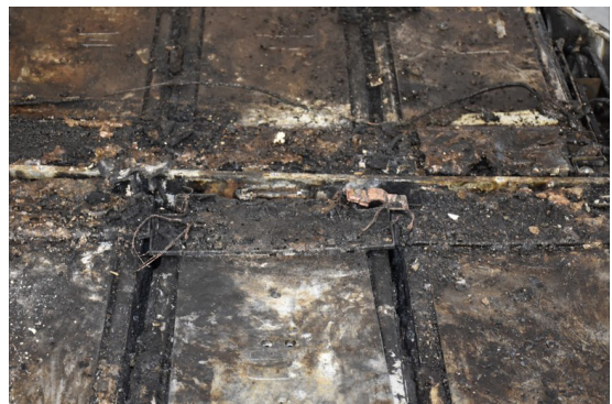
圖 15、橋接鋰電池組之電樁頭受燒熔融重
