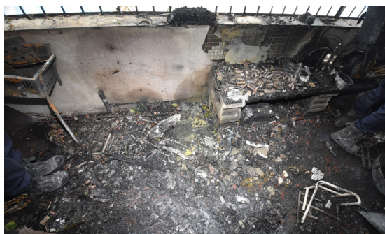
圖 8、檢視電動載具停放處地面散落大量電池芯及內部極板
