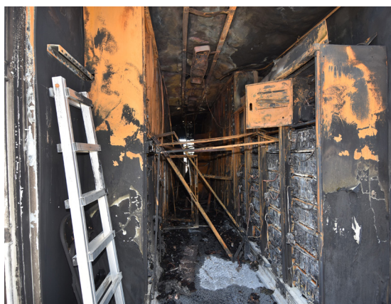
圖 18、儲能櫃內鋰電池受火燒燬
