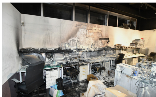
圖 9、維修區內工作桌及層板擺放多支待修手機及平板電腦部分受燒損
