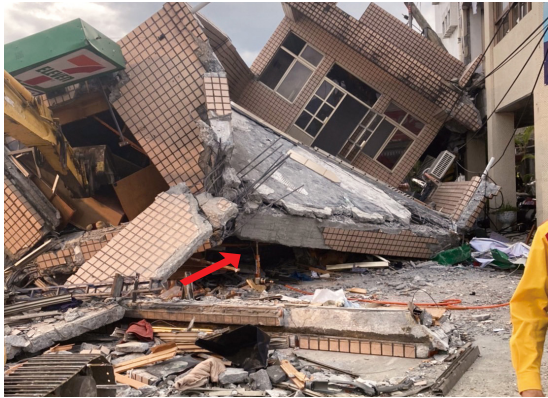
圖 5、7-11 玉明門市倒塌，現場人員於 3 樓露臺下進行油壓支撐柱之單點支撐
