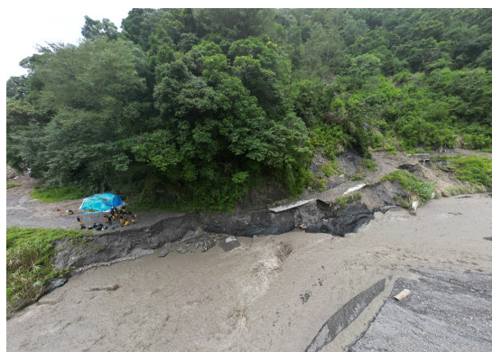
圖 4、南投仁愛鄉因土石流造成路基崩塌
