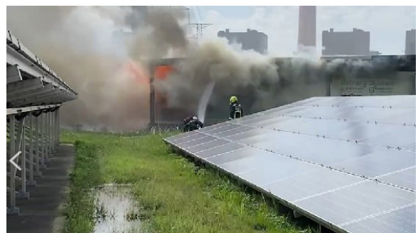
圖 4、臺中市龍井區工研院綠能所示範案場儲能系統火災（圖片來源：經濟日報）
